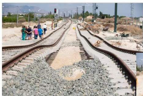
Vista general de los daños en la LAV. Sentido del flujo de margen derecha a izquierda.
