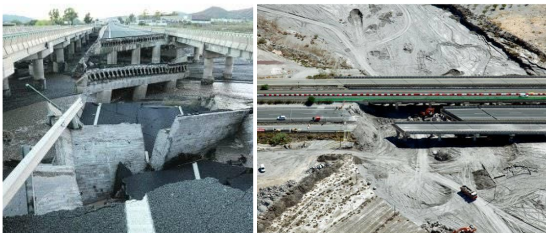
Efectos de la avenida de San Wenceslao (2012) en el puente de la A-7 entre Lorca y Puerto Lumbreras a su paso por la Rambla de Béjar
