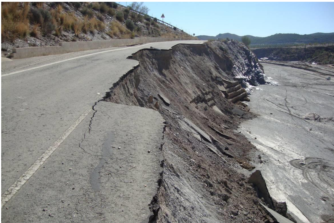
Daños causados en la N-342 por la rambla de Nogalte durante la avenida de San Wenceslao (2012), en el término municipal de Puerto Lumbreras. Al fondo de la imagen se observa la señalización de la autovía A-91 que es paralela a la rambla y a la carretera.
